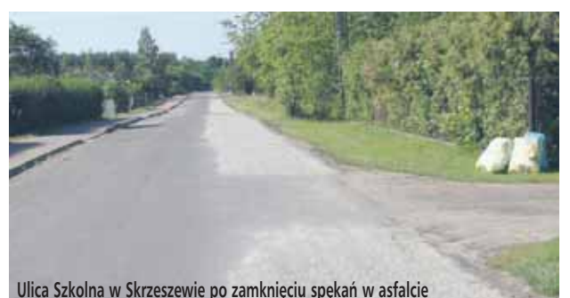
Ulica Szkolna w Skrzyszewie po zamknięciu spēkań w asfalcie
