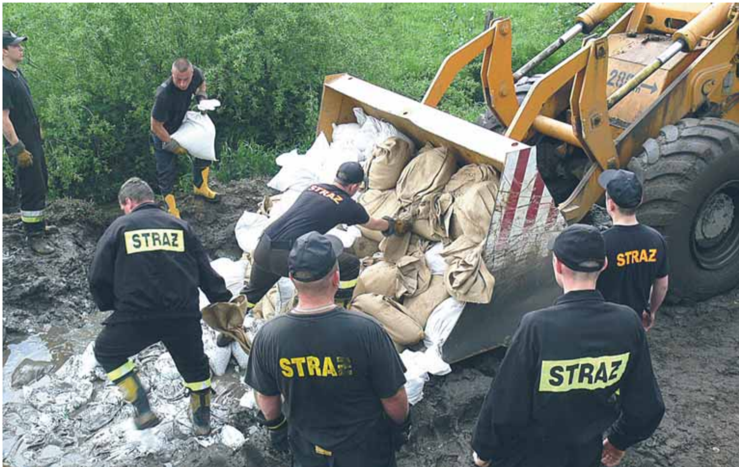
Za wałem Wielka Woda. Należy umocnić drogę prowadzącą do umocnień przeciwpowodziowych
